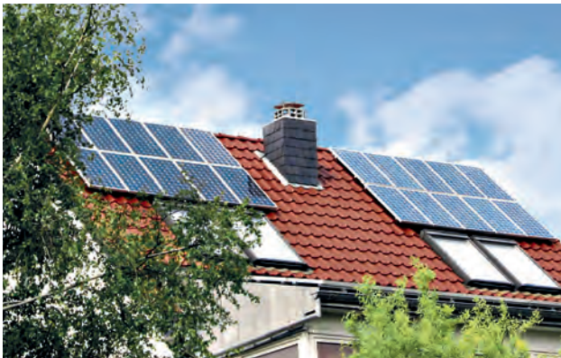
Fotovoltaikanlage auf dem Hausdach
